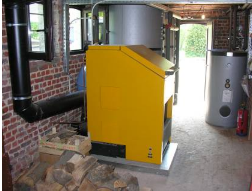
Chaudière à bûches de la Maison forestière de la Drève des Bonniers (Watermael-Boitsfort).
